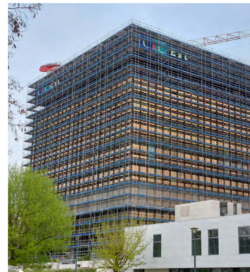
Le siège du CIC Est à Strasbourg actuellement en travaux : un grand chantier pour répondre aux enjeux écologiques
